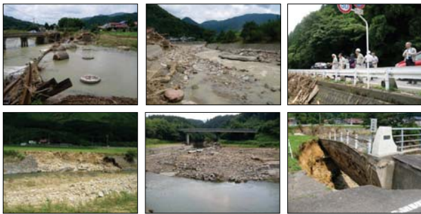
【土木学会中国支部緊急災害調査(2013年8月3日調査)】
